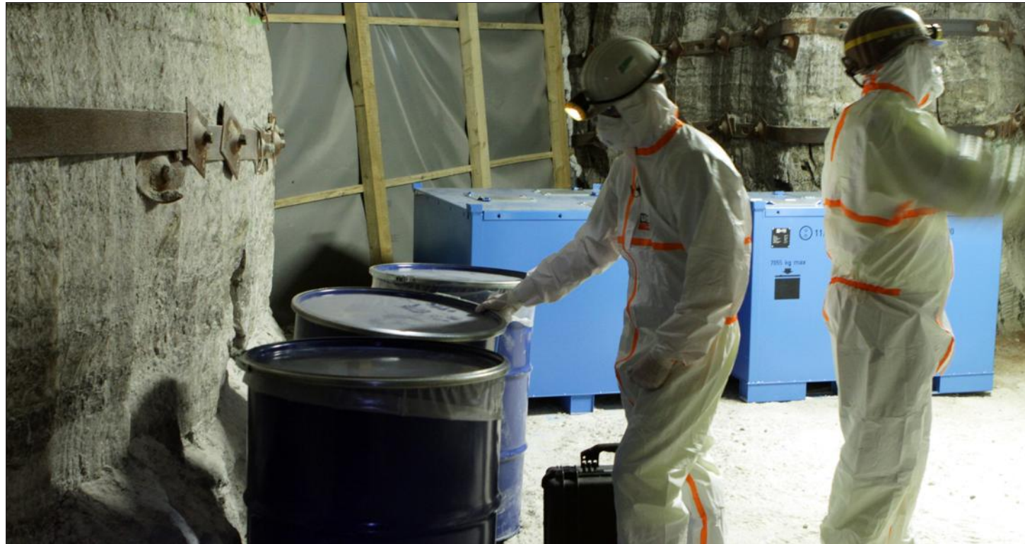
Le contenu des fûts de déchets mercuriels et arséniés doit être reconditionné en fond de la mine avant d'envisager toute remontée au jour. C'est dans cette opération que réside la principale difficulté du chantier.
