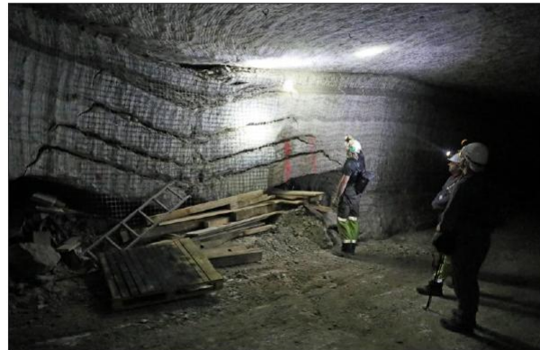
L'effondrement du toit d'une galerie remblayée en sa partie inférieure : la dégradation de la mine fait craindre l'impossibilité de déstocker au milieu des allées de stockage des déchets. Photo L'Alsace
