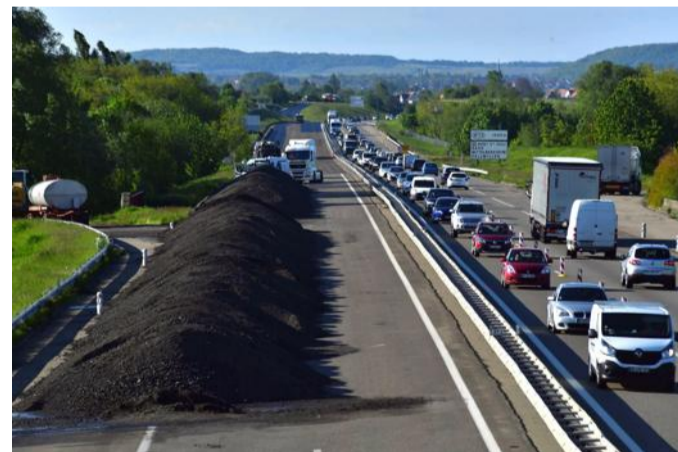
Le chantier condamne les deux voies de circulation dans le sens Strasbourg-Colmar.
